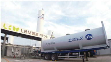
液化バイオメタンの製造プラント=北海道帯広市
